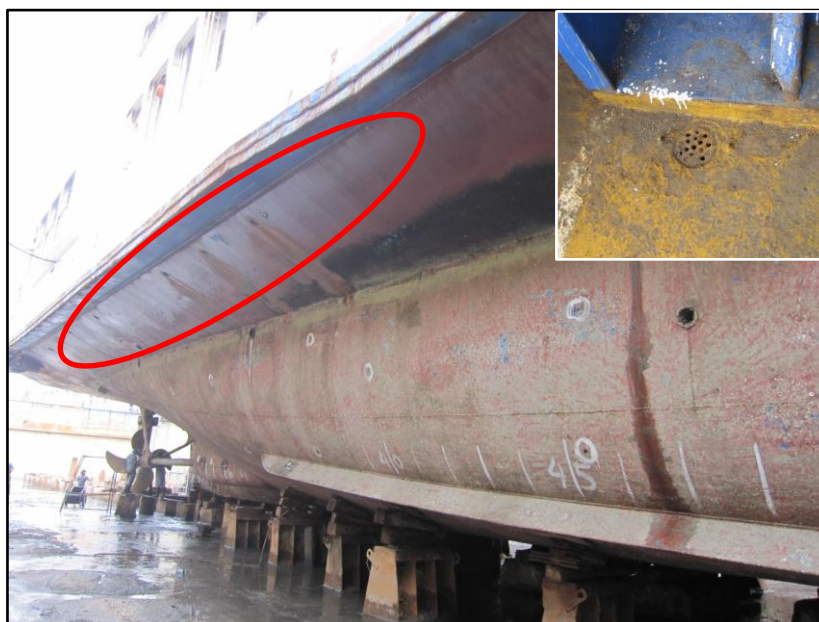
Gambar I-10: contoh lubang scupper yang terpasang di KMP. Rafelia 2. Lingkaran merah adalah posisi buangan scupper di sisi luar kapal. Inzet: kondisi lubang di atas geladak kendaraan. Foto didapatkan dari pemeriksaan penerimaan klas yang dilakukan oleh Biro Klasifikasi Indonesia pada tahun 2012.
