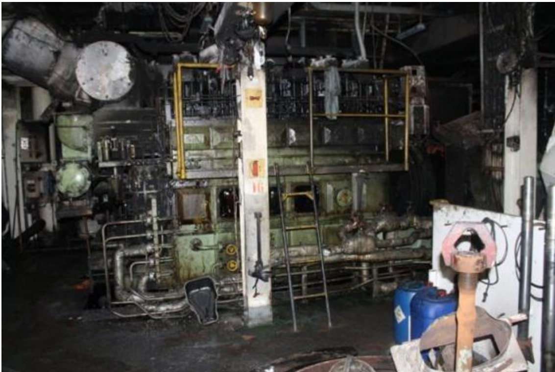
Gambar I-3: kondisi mesin AE No. 2 setelah kecelakaan tampak samping
