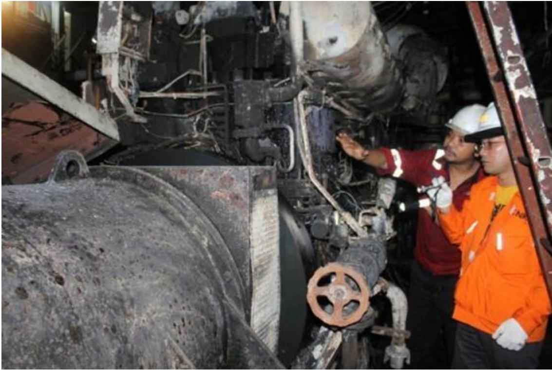
Gambar I-2: kondisi mesin AE#2 setelah kecelakaan tampak depan
