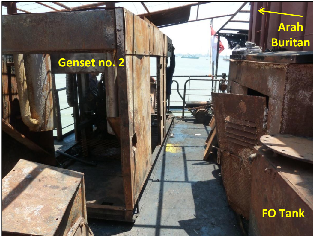
Gambar I-7: Kondisi genset no. 2
