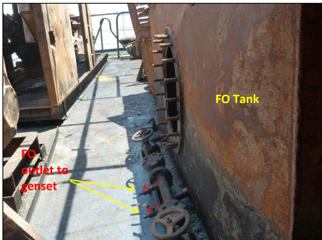
Gambar II-5: Tangki bahan bakar genset dengan 2 saluran keluaran ke genset
