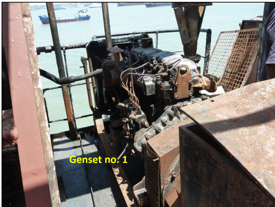
Gambar I-6. Kondisi genset no. 1
