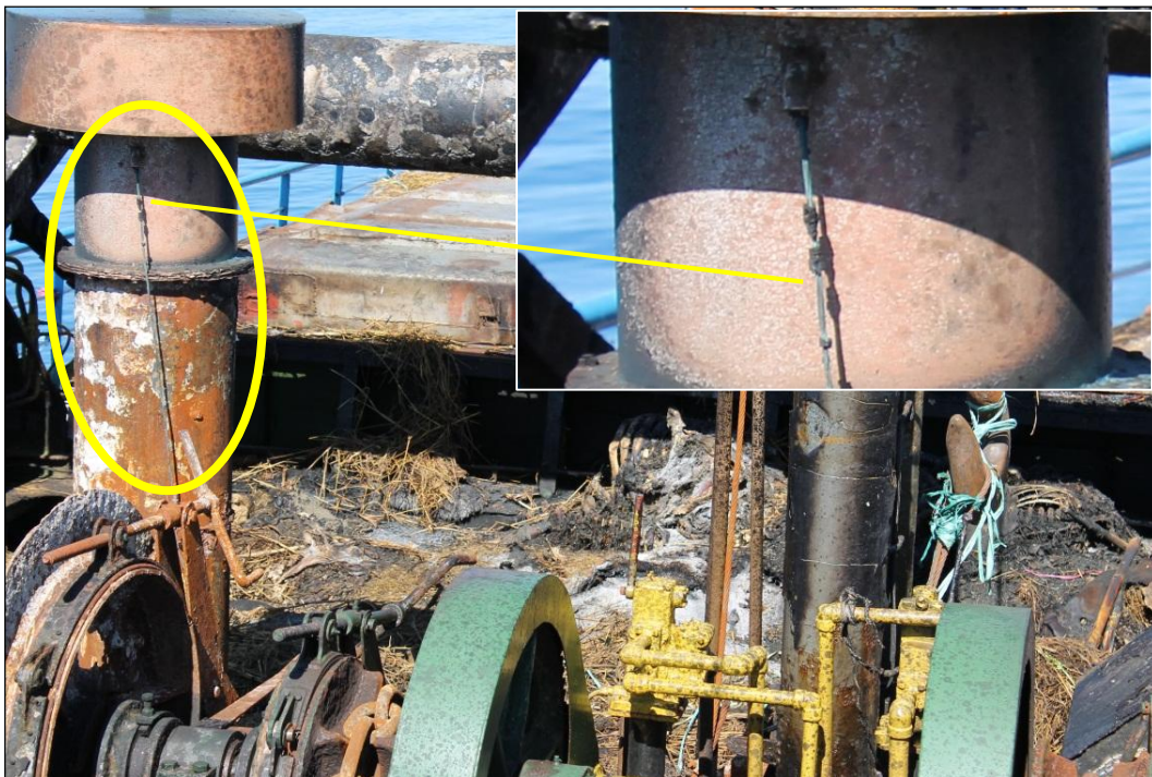
Gambar II-3: instalasi kabel listrik terbuka di depan geladak agil (lingkaran kuning)
