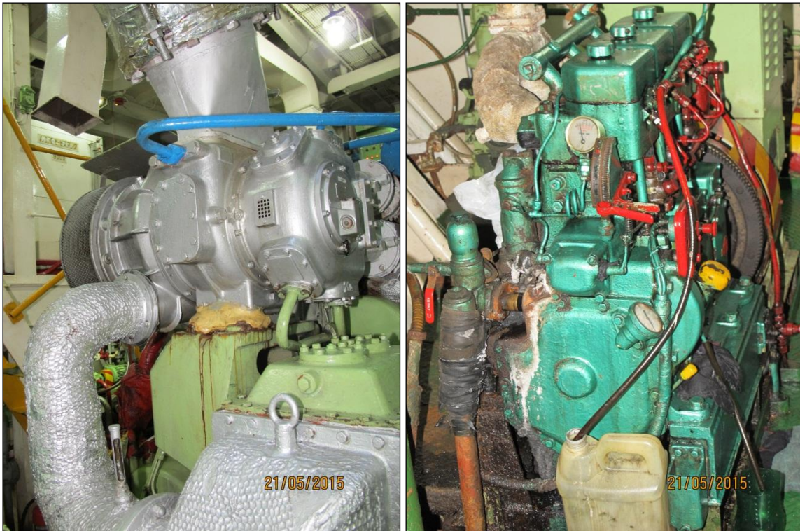
Gambar I-6: Kondisi Mesin Induk (kanan) dan mesin bantu (kiri) di Asia Raya
