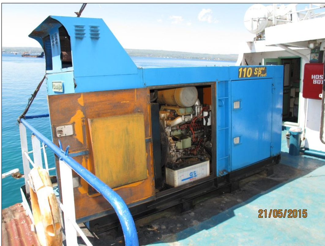
Gambar I-5: Genset Tambahan yang terpasang di geladak akomodasi kapal
