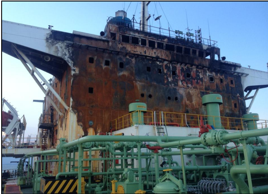
Gambar I-5: Kerusakan akibat kebakaran di bangunan akomodasi hingga anjungan
