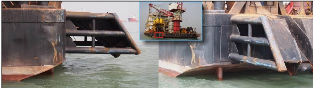
Gambar I-4: Kerusakan pada Crane Barge AWB Labuhan 2310
