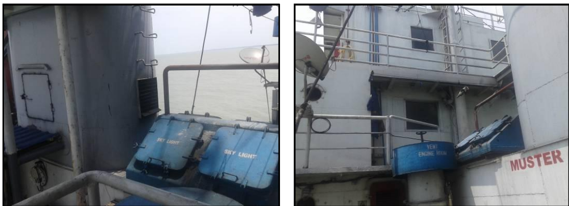
Gambar I-3: Kondisi skylight dan ventilator ruang mesin di buritan
