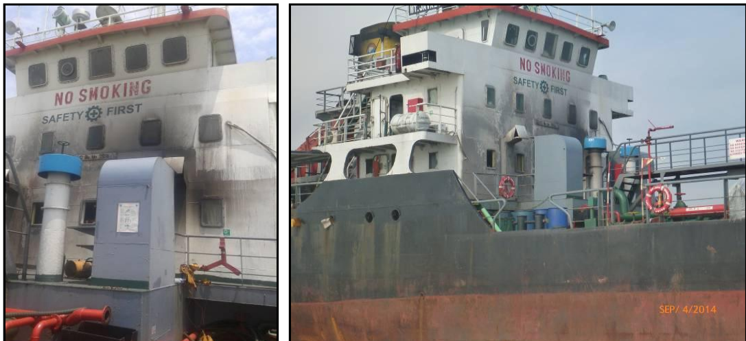
Gambar I-2: Kondisi dinding bangunan atas setelah ledakan
