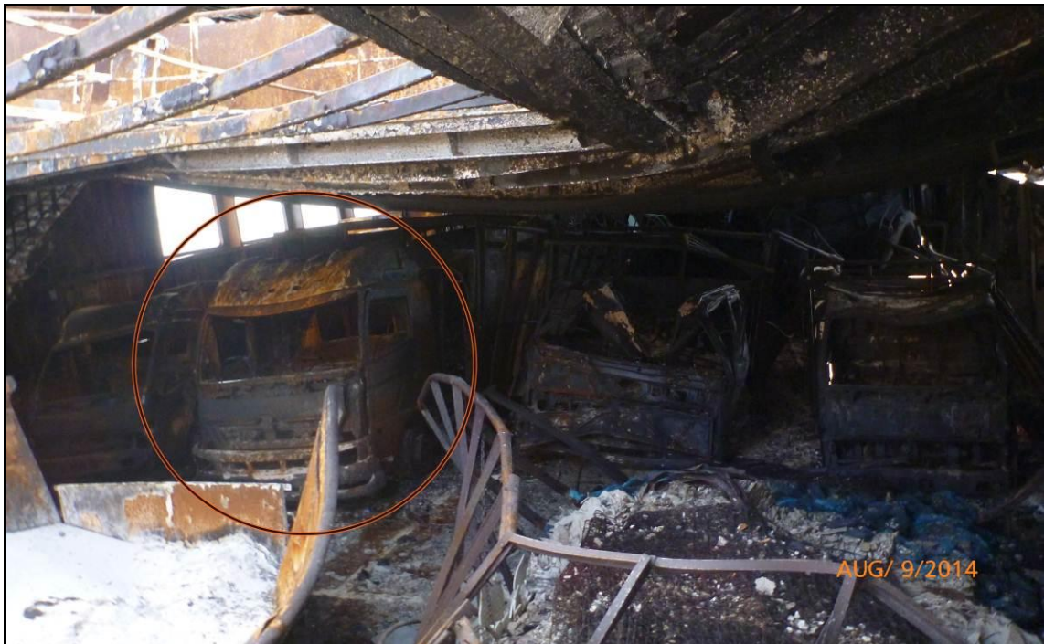
Gambar II-1: Posisi truk yang teridentifikasi sebagai awal terjadinya kebakaran (tanda lingkaran)
