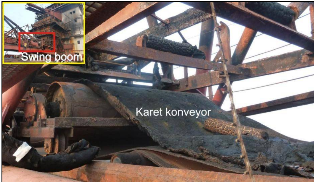
Gambar II-8. Kondisi karet konveyor swing boom yang terbakar
