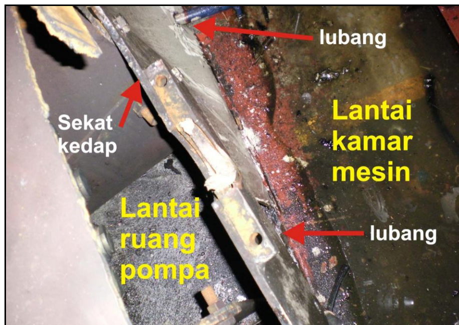
Gambar II-2: Lubang pada sekat antara ruang pompa dan kamar mesin
