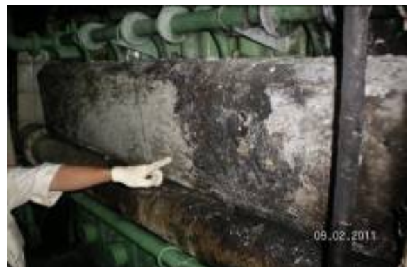
Gambar II-1: posisi titik awal kebakaran
