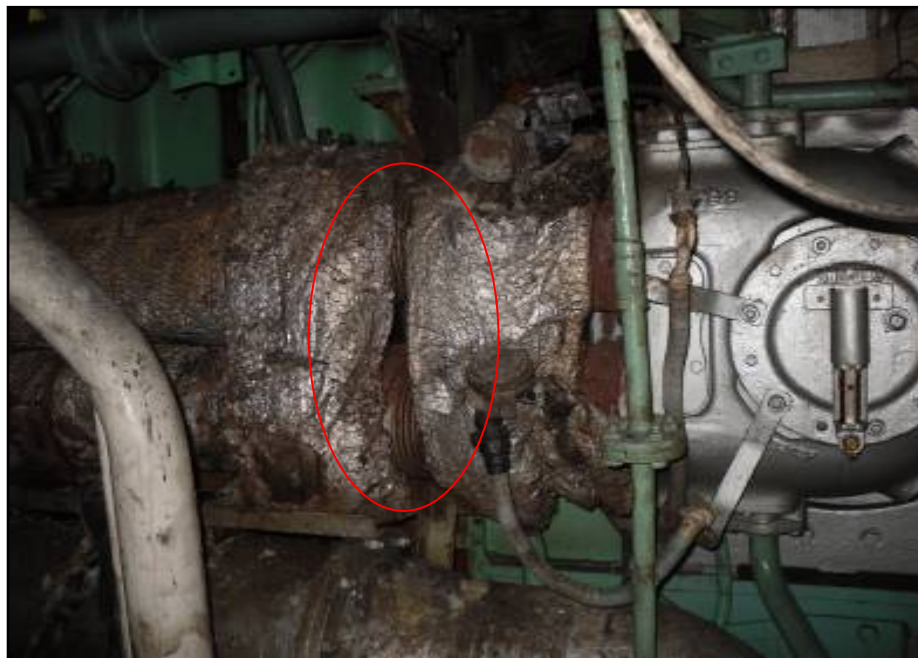
Gambar II-2: Manifold gas buang yang tidak terbungkus Glasswool dengan rapi
