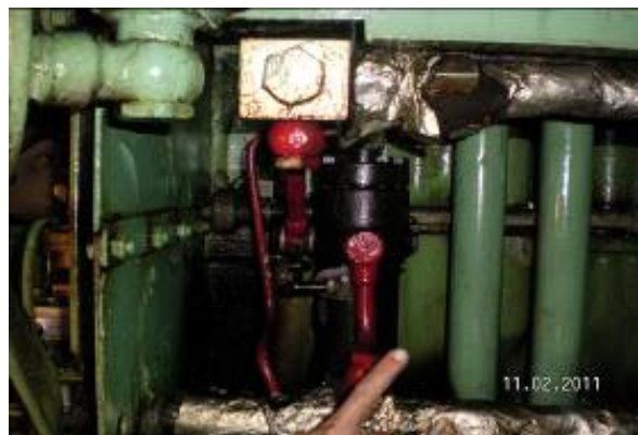
Gambar I-8: Adanya kebocoran pada pipa bahan bakar tekanan tinggi pada pompa bahan bakar silinder no. 1.
