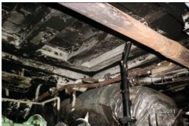
Gambar I-7: Area di atas mesin induk kiri yang mengalami kerusakan
