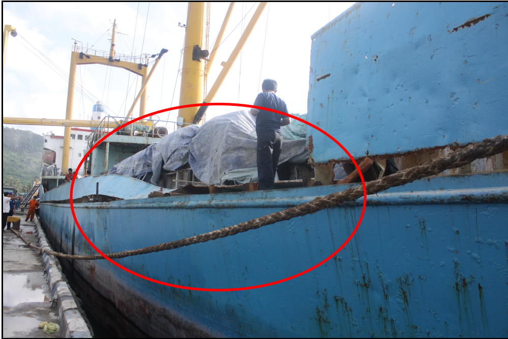
Gambar I-5 Kerusakan Bulwark KM. Bosowa roboh sepanjang \pm 20 meter dan lambung kanan dibawah garis air melengkung masuk (penyok)
