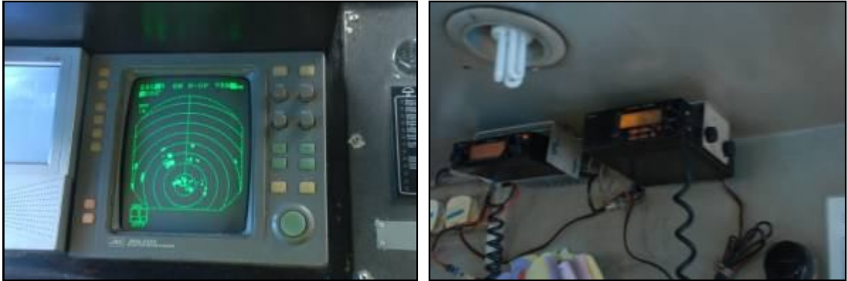
Gambar I-3 Radar dan radio komunikasi yang terpasang di KM. Dumai Express 10
