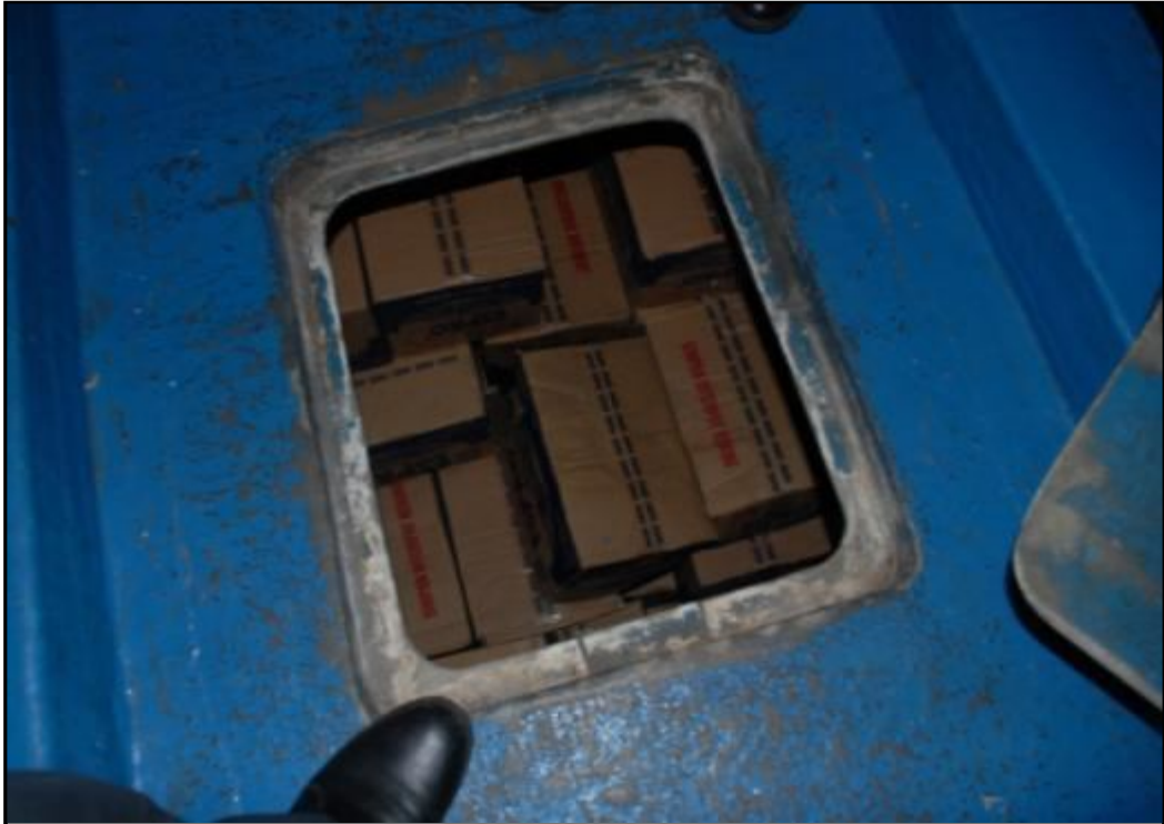
Gambar II-5 Lubang akses yang tidak kedap ke kompartemen di bawah ruang akomodasi penumpang geladak utama yang digunakan untuk penyimpanan barang
