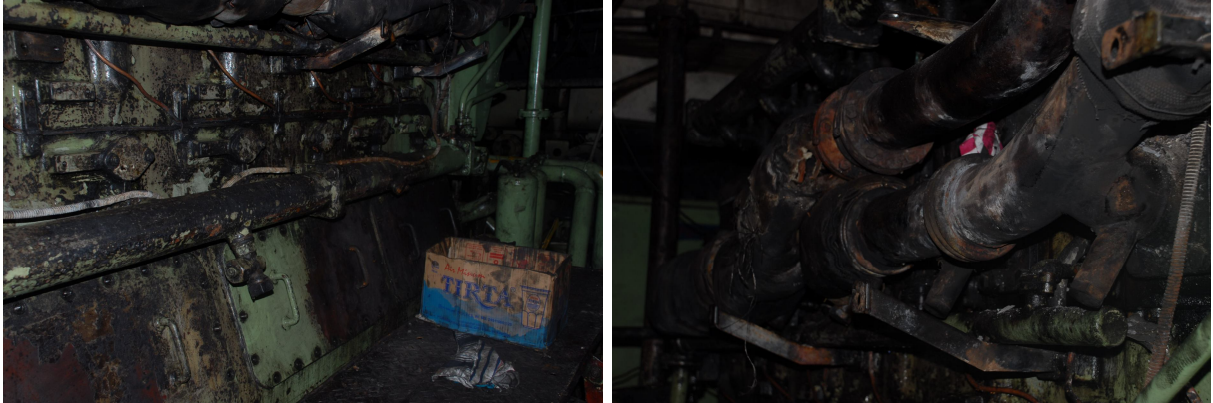
Gambar I-5 kerusakan pada engine cover dan saluran gas buang dari AE no.2
