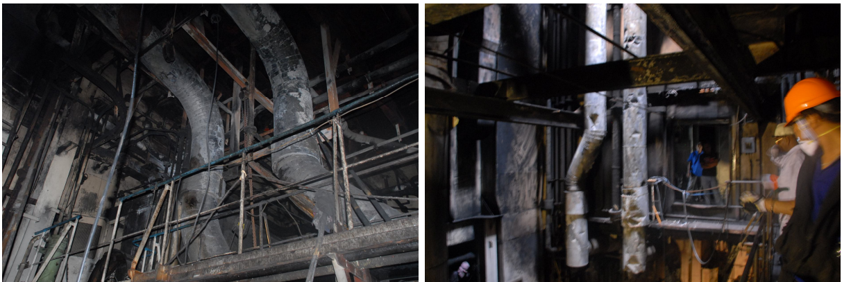
Gambar I-6 Kerusakan pada daerah cerobong (funnel)
