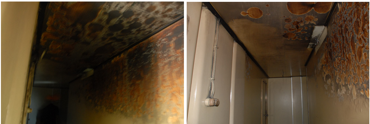
Gambar I-7 Kerusakan ringan pada dinding akomodasi di geladak yang tidak terhubung langsung dengan bukaan-bukaan kamar mesin
