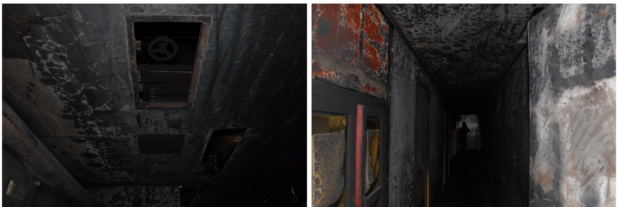
Gambar I-4 Kerusakan pada dinding di gang-gang ruang akomodasi yang berhubungan langsung dengan bukaan kamar mesin
