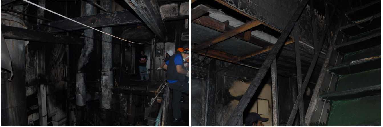
Gambar II-6 tingkat kerusakan pada bagian atas AE dan kerusakan pada tangga akomodasi
