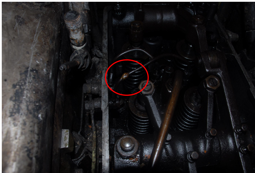
Gambar II-1 Penambalan pada pipa injector bahan bakar di cylinder no.2 AE no.2
