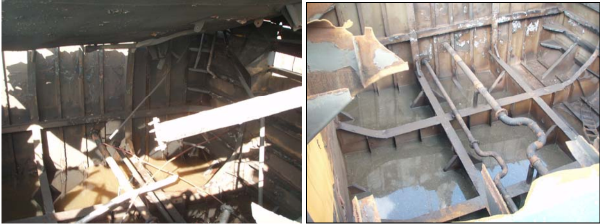
Gambar I-4 Kondisi dalam tangki nomer 3 kanan kiri setelah ledakan
