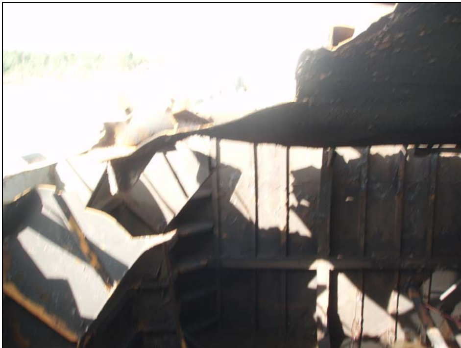
Gambar II-2 Kerusakan bagian dinding dan geladak tangki 3 sebelah kiri
