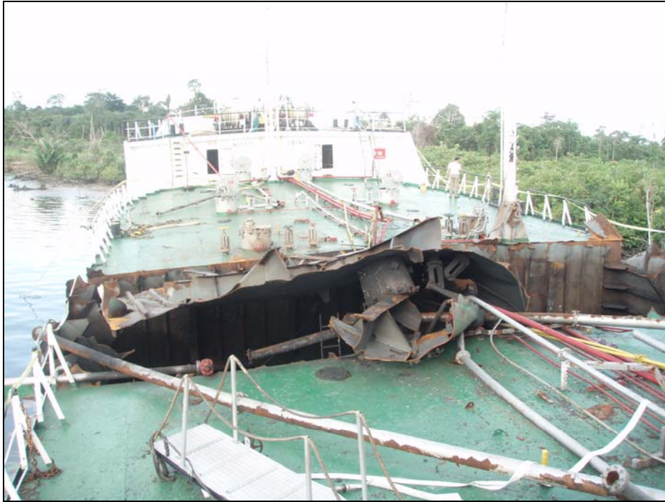
Gambar II-1 Kondisi dek di atas tangki 3 akibat ledakan
