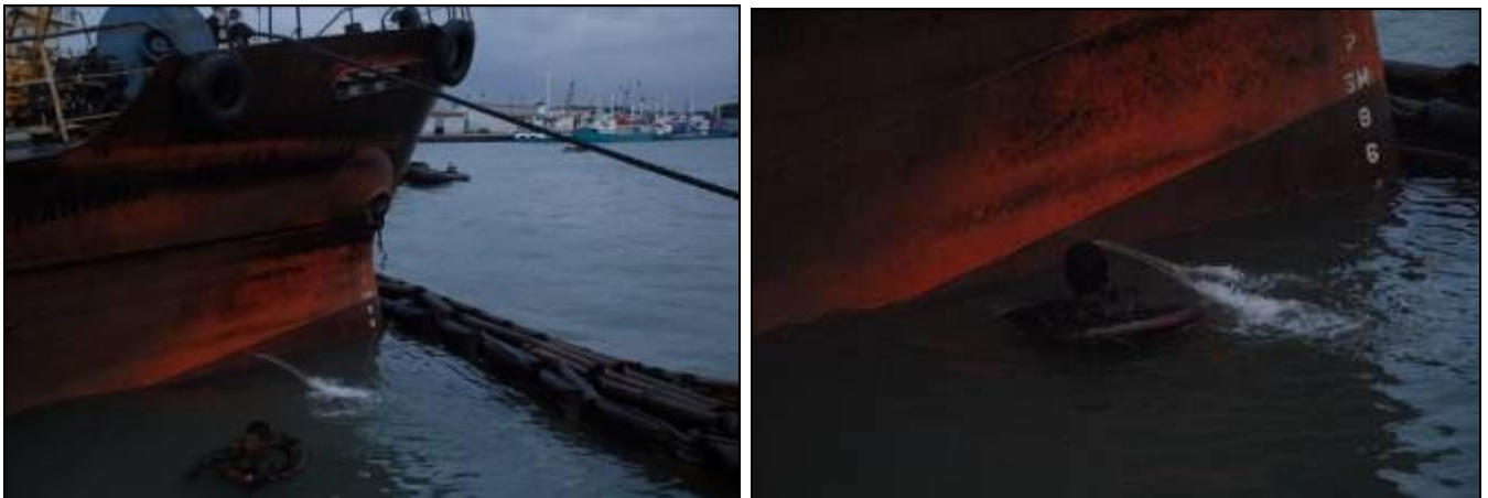
Gambar II-1 air keluar dari kebocoran pada lambung bagian haluan kapal
