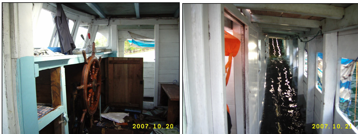
Gambar I-10 Kondisi Anjungan dan bagian akomodasi
