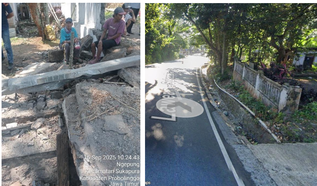
Gambar 13. Jembatan beton di atas saluran drainase rusak ditabrak mobil bus (foto kanan sumber : Google Map 2025)
