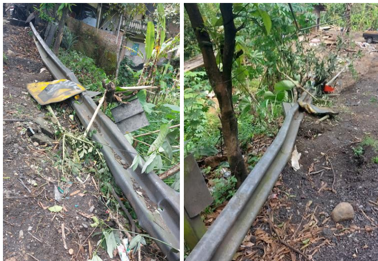
Gambar 12. Kerusakan guardrail dan rambu chevron
