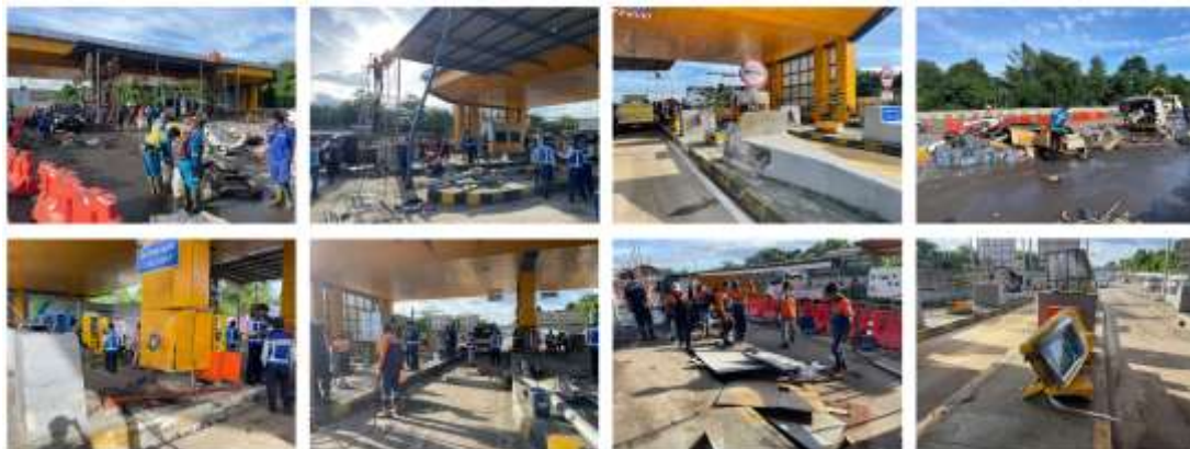
Gambar 24. Kondisi prasarana jalan tol dampak kecelakaan Sumber: PT Jasa Marga (Persero) Tbk
