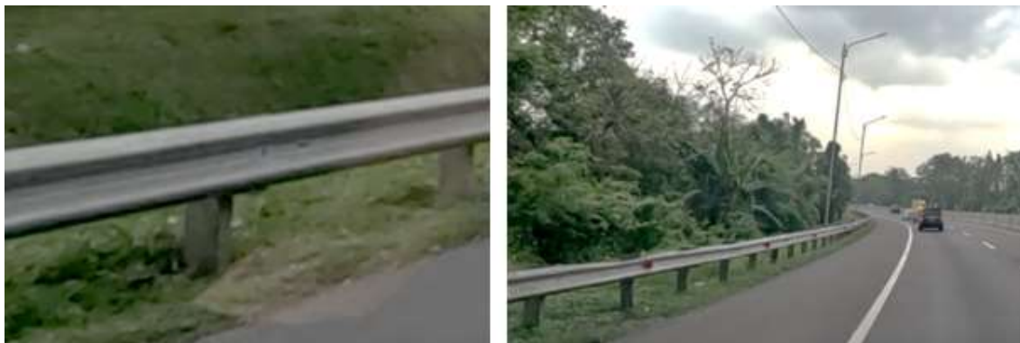
Gambar 14. KM 93+000B dan KM 96+800B perbedaan tinggi bahu jalan dengan bidang datar tanah, dimana bidang datar tanah sedikit lebih rendah dari tepi badan jalan
