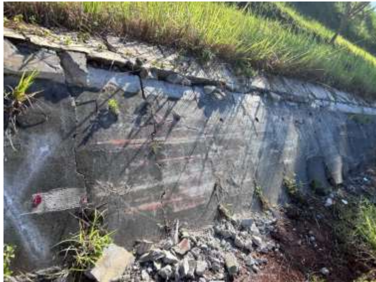
Gambar 10. Bekas gesekan badan mobil bus masuk ke dalam saluran samping jalan tol
