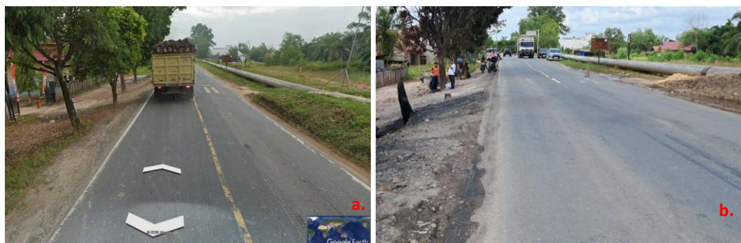
Gambar 9. Kondisi marka jalan (a) Agustus 2023, (b) Setelah kecelakaan
