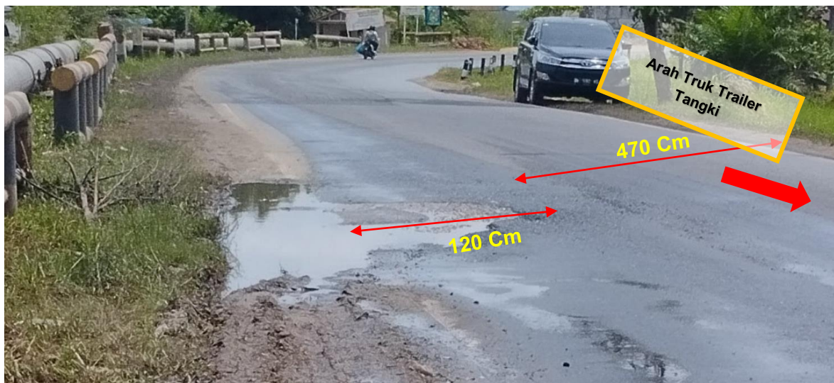
Gambar 6. Kondisi Lubang di Permukaan Jalan
