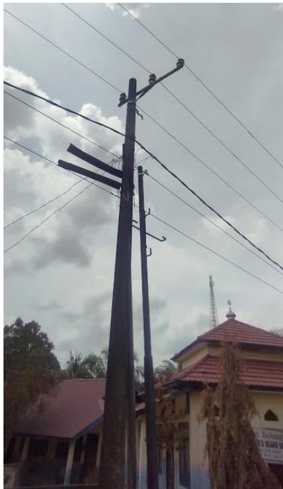
Gambar 15. Tiang Listrik Jaringan Tegangan Menengah 20 Kv
