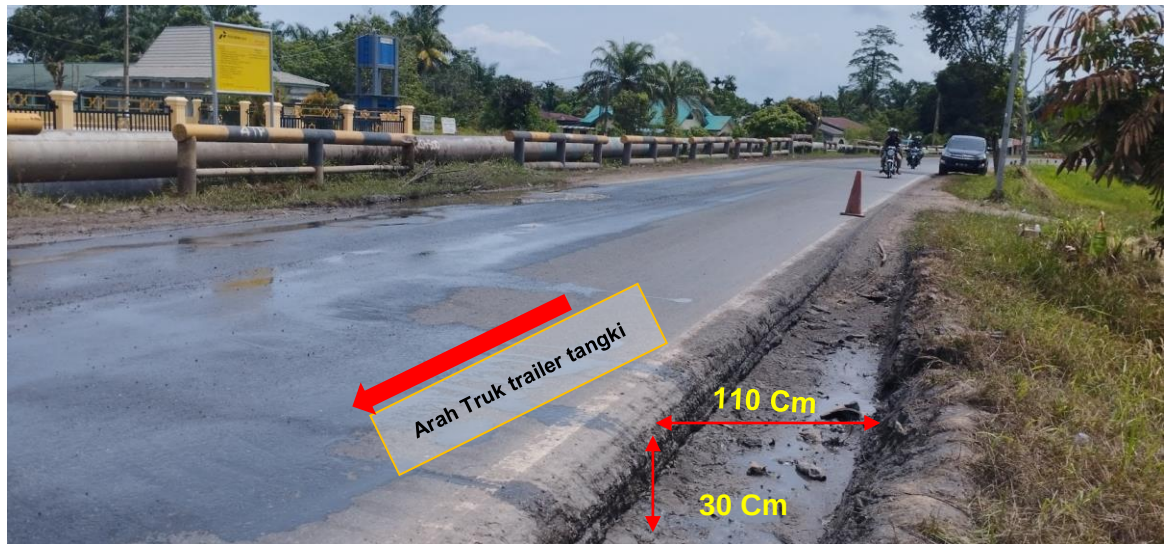
Gambar 7. Kondisi Lubang di Bahu Jalan
