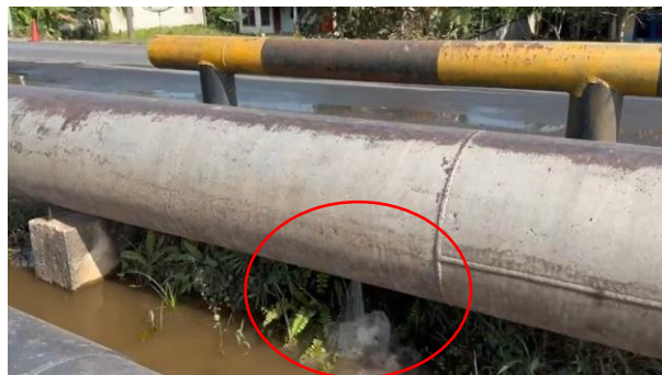
Gambar 29. Kebocoran Pada Pipa Air Di Lokasi Kejadian Kecelakaan (Foto Diambil 2 Hari Setelah Kejadian Kecelakaan, 27 Februari 2024)
