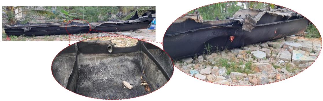
Gambar 23. Ditemukan Deformasi Pada Bagian Tengah Tangki Sebelah Kiri Pada Satu Titik.
