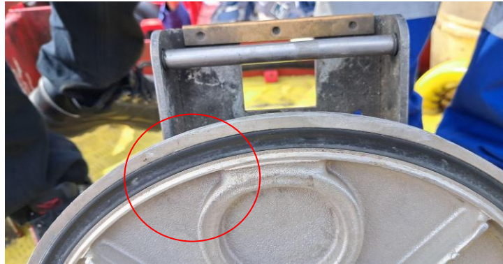
Gambar 25. Kondisi Karet Manhole Yang Mengalami Sobek
