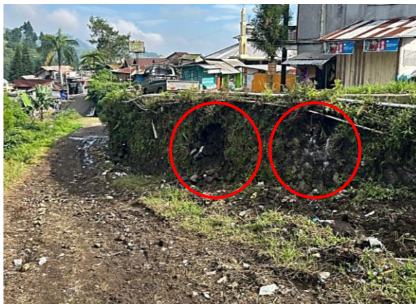
Gambar 11. Lereng talud yang tertabrak mobil bus
