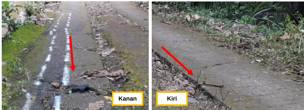
Gambar 16. Perkerasan Jalan dari Arah Tapak Ban Mobil Bus
