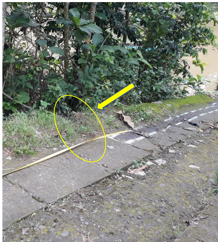
Gambar 11. Bekas Terbakarnya Rumput Pada Sisi Pipa Gas Buang
