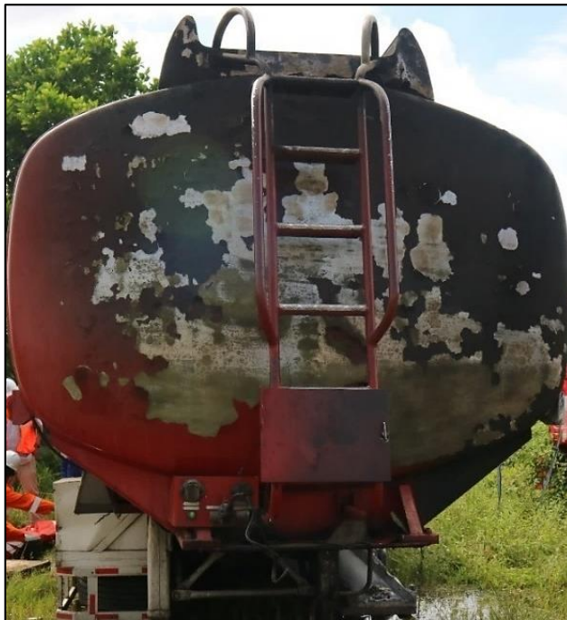
Gambar 4. Dinding depan trailer tangki bentuk utuh dan cat terkelupas
