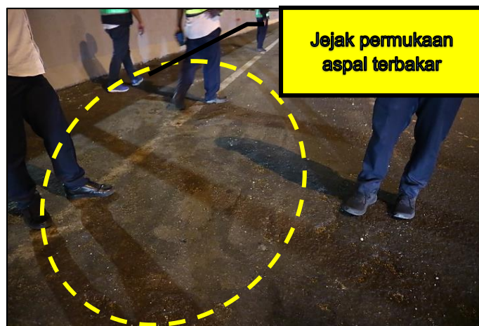
Gambar 14. Terdapat jejak terbakar di permukaan jalan tol
