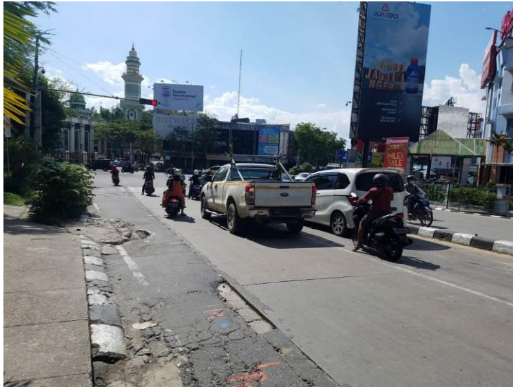
Gambar 9 Kerusakan perkerasan badan jalan
