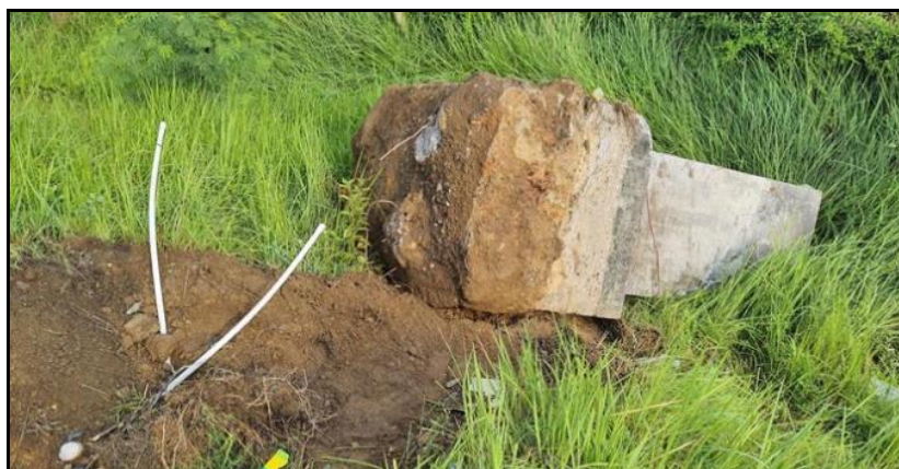
Gambar 9. Pondasi VMS yang rusak akibat tertabrak bus wisata
