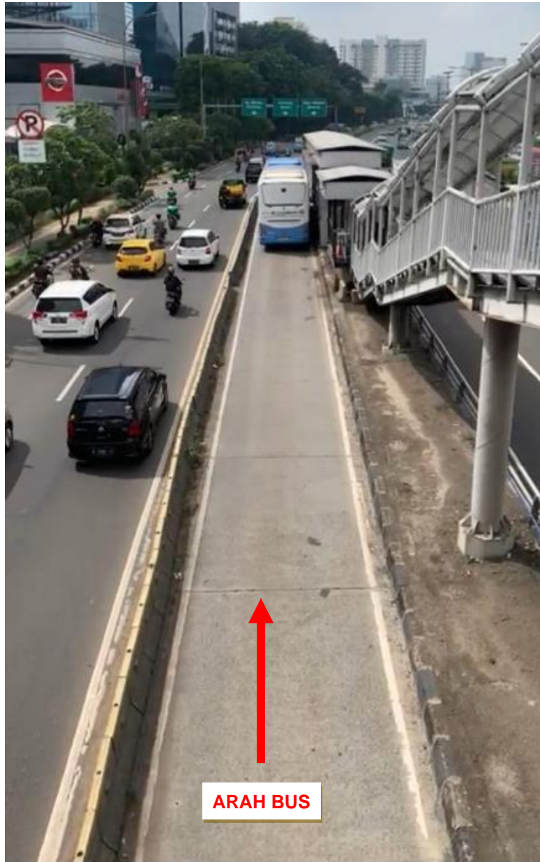
Gambar 13: Kerusakan Perkerasan Jalan
