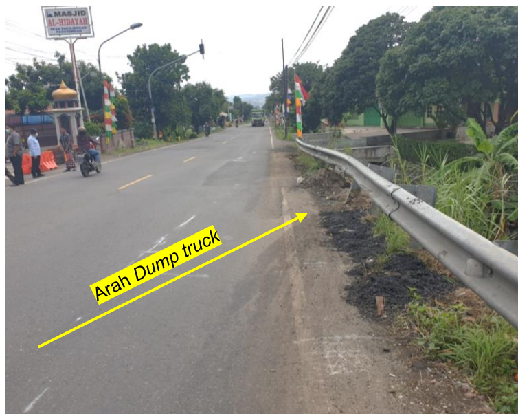
Gambar 6. Guardrail yang tertabrak dump truck
