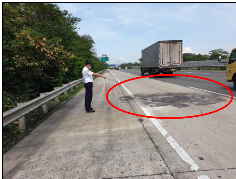
Gambar 7. Ruas jalan tol Jagorawi Km 18 berwarna hitam akibat terbakarnya truk tangki trailer
