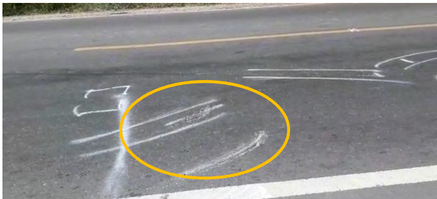
Gambar 12. Kerusakan Perkerasan Jalan
