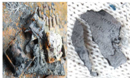
Gambar 7. Kotak sekring utama, 5 relay dan kertas terbakar
