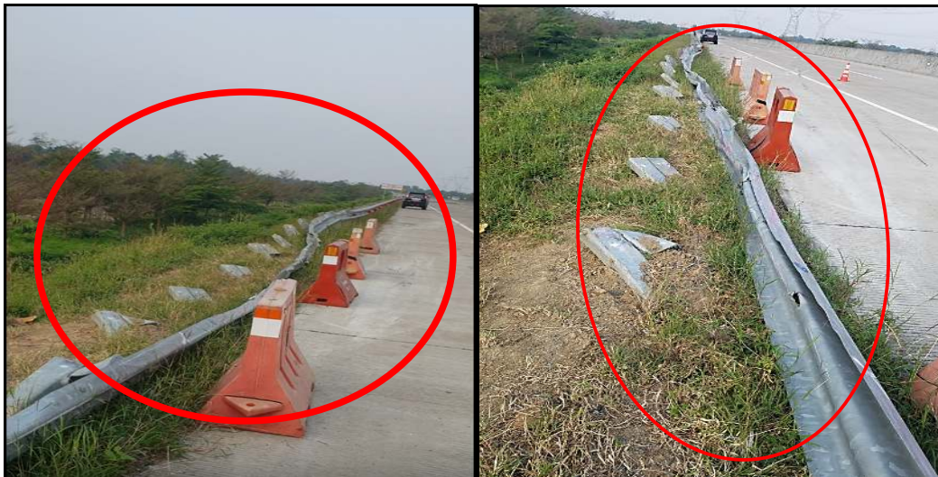
Gambar 16. Kondisi guardrail terdeformasi setelah tertabrak bus
