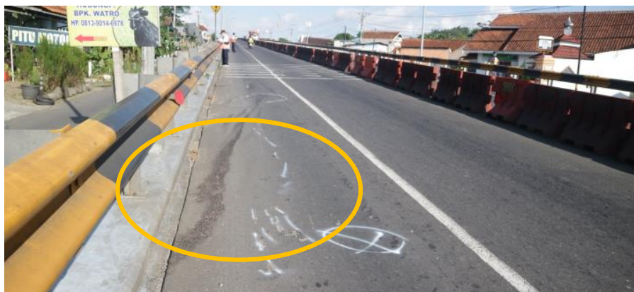
Gambar 6. Kerusakan Perkerasan Jalan
