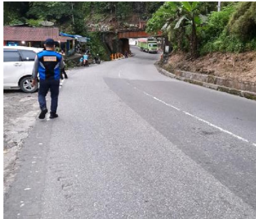
Gambar 14. Marka tepi dan marka tengah pudar dekat lokasi kecelakaan
