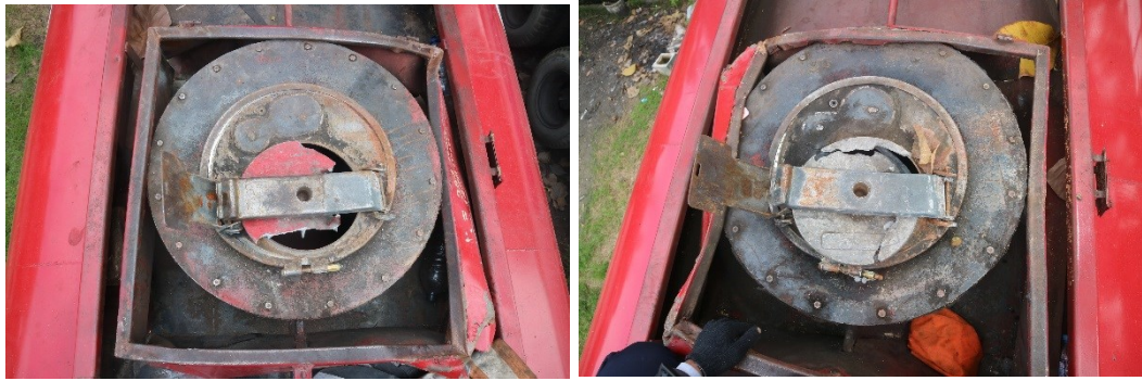
Gambar 4. Kedua tutup main hole mobil tangki yang pecah.
