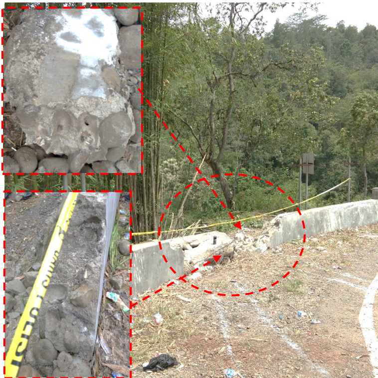
Gambar 10. Pagar Pengaman Jalan dari beton yang jebol tertabrak mobil bus
