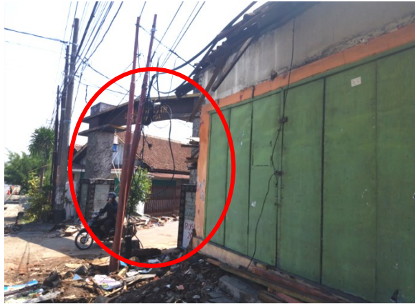
Gambar 16. Tembok toko yang ditabrak truk flat deck
