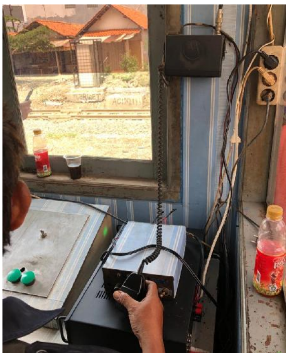
Gambar 17. Peralatan telekomunikasi Radio Rig di JPL 101
