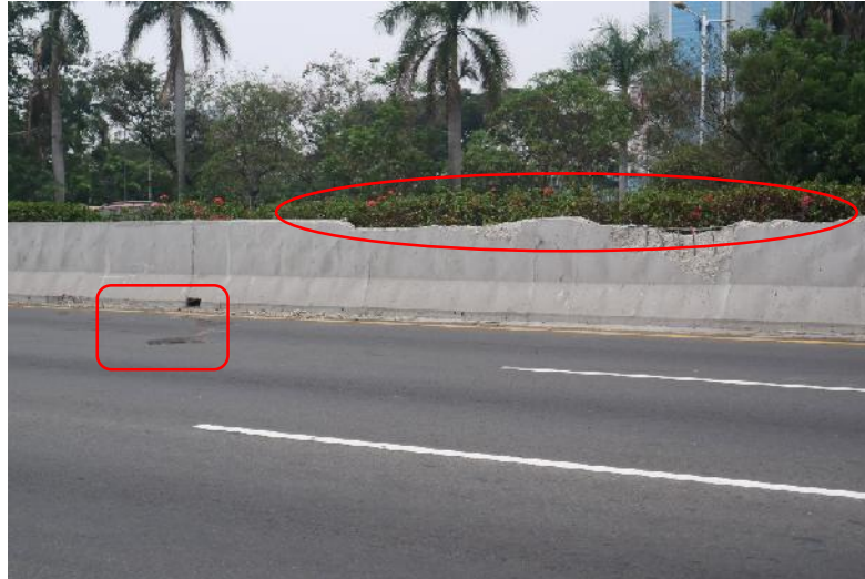
Gambar 16. Kerusakan MCB dan Perkerasan Jalan
