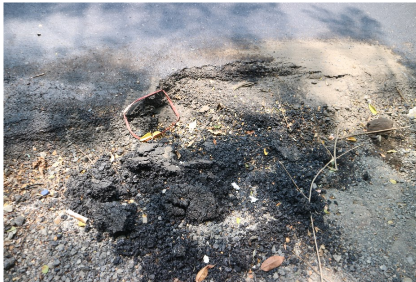
Gambar 6. Runtuhan aspal di tepi permukaan jalan
