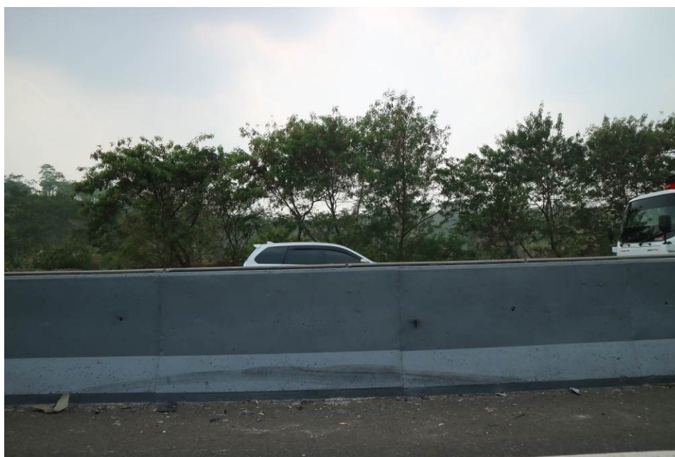
Gambar 4. Median tengah jalan yang terserempet oleh dump truck B.
