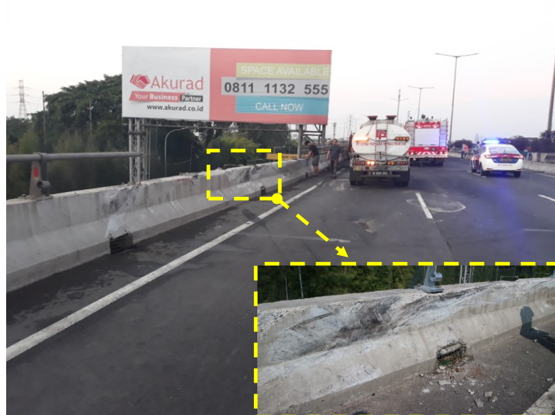
Gambar 12. Scratch Mark Mobil Penumpang Setelah Ledakan di Pagar Pengaman Jalan
