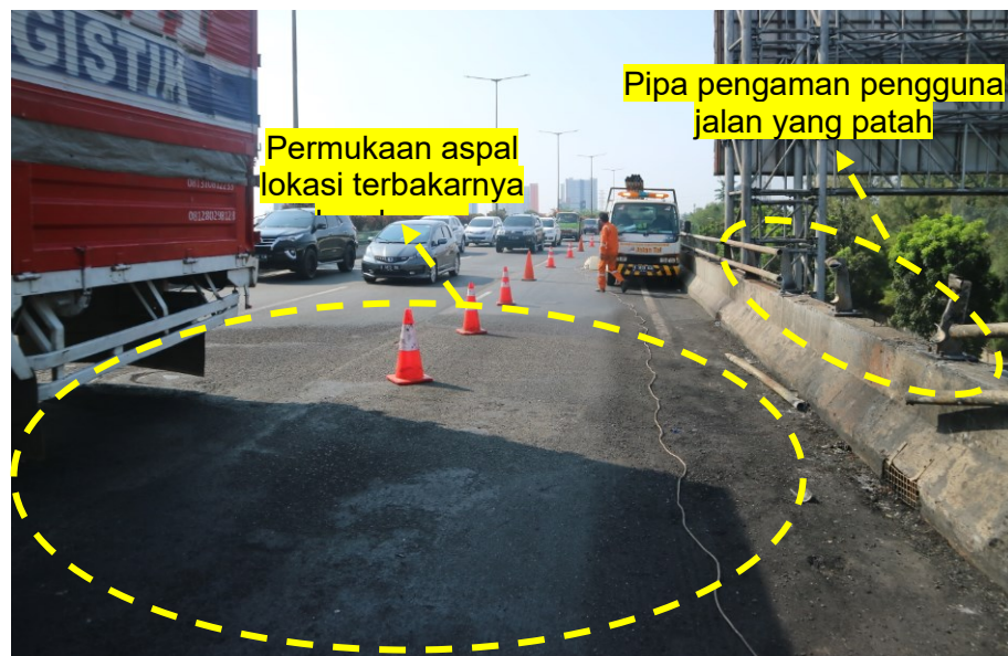
Gambar 26. Kerusakan Permukaan Aspal Setelah Kebakaran Kendaraan
