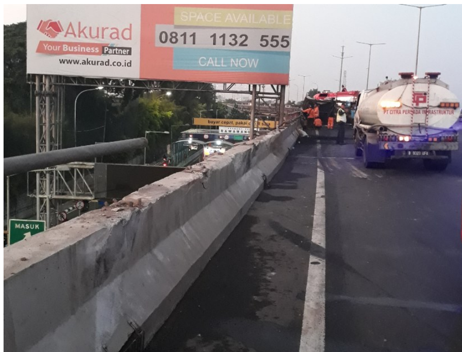
Gambar 25. Pagar Pengaman Jalan Patah Setelah Tertimpa Tractor Head
