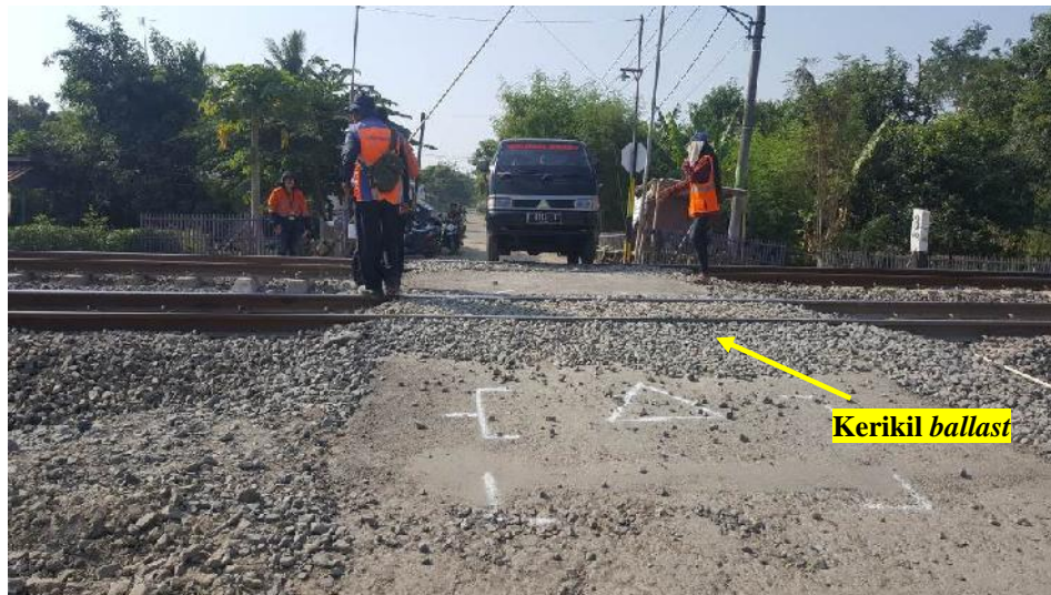
Gambar 20. Kondisi segmen jalan tepat di perlintasan sebidang.
