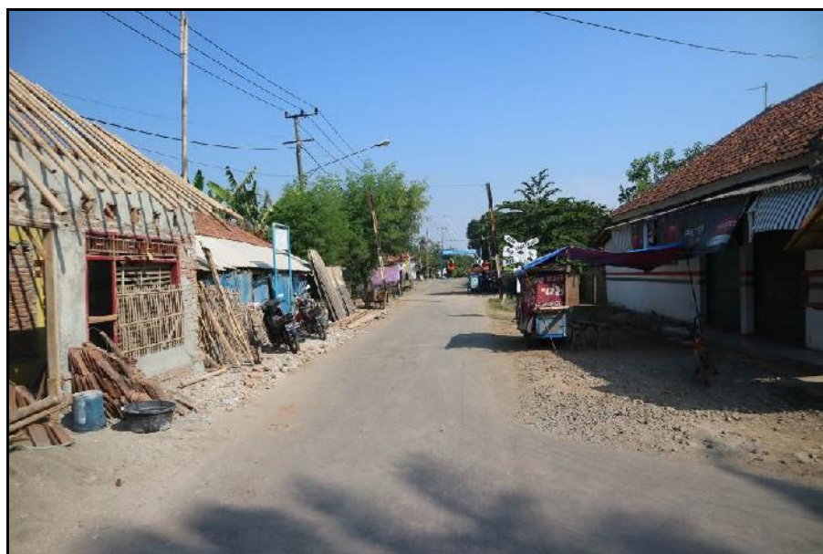
Gambar 27. Ruas jalan PU Jayamulya tidak terdapat marka.
