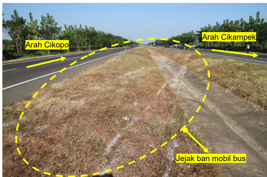
Gambar 10. Skid mark pada median (drainase terbuka) jalan tol Cipali
