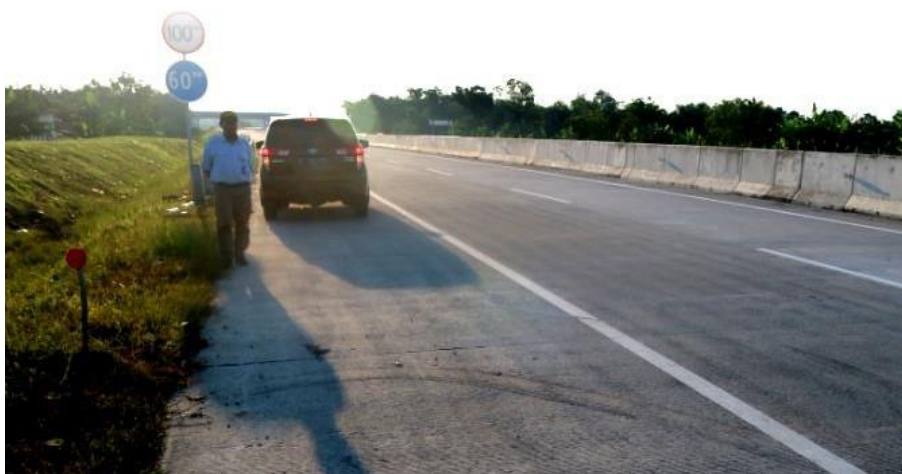
Gambar 19. Jalur arah kecelakaan : lalu lintas 2 lajur searah, rambu batas kecepatan, median jalan pagar pengaman kaku reflektif dan patok reflektif
