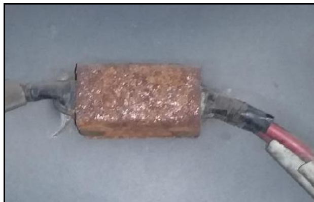
Gambar 18. Dudukan fuse Baterai dapat digoyang dan materialnya sudah karatan berat
