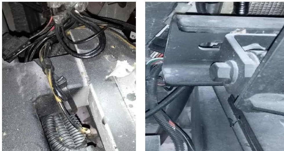
Gambar 30. Kabel tanpa konduit dekat mesin dan bersentuhan dengan metal
