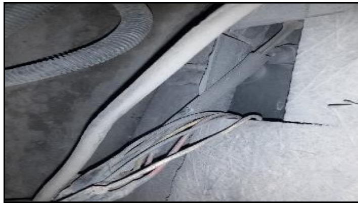
Gambar 9. Tidak ada clamp untuk menjaga agar kabel tidak menyentuh
