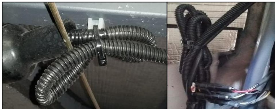
Gambar 28. Kabel dengan bungkakan (bending) terlalu tajam
