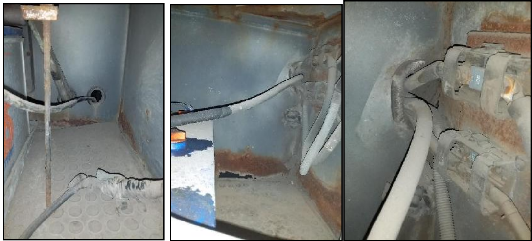
Gambar 20. Korosi berat pada baterai kompartmen
