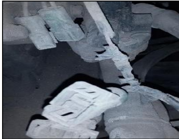
Gambar 17. Konektor yang tidak digunakan tidak diperbolehkan terbuka
