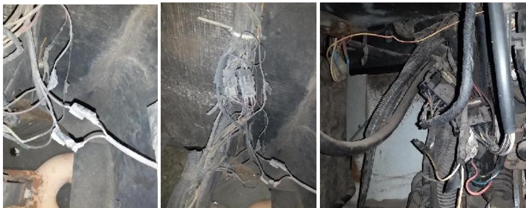
Gambar 12. Instalasi kabel tidak sesuai dengan standar industri
