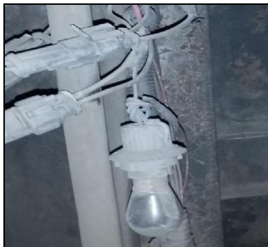
Gambar 16. Instalasi Lampu gantung tanpa dudukan rigid
