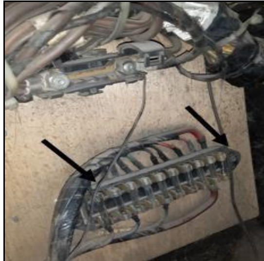
Gambar 22. Kabel menyentuh sekering (fuse) karena tidak dipasang dengan benar
