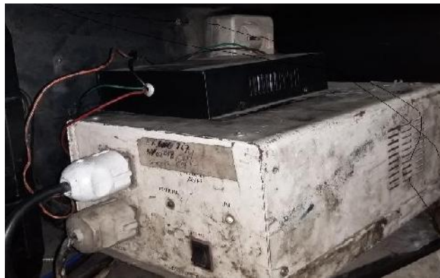
Gambar 19. Inverter dipasang begitu saja tanpa dudukan yang benar
