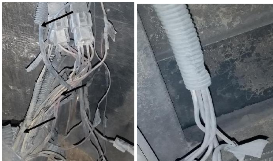
Gambar 14. Pemasangan Konduit Yang Tidak Menyeluruh
