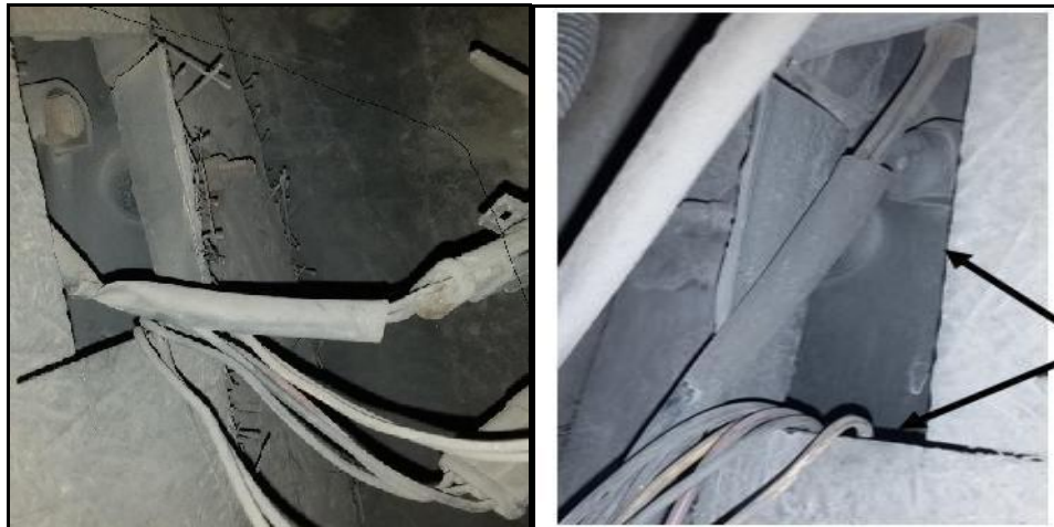
Gambar 6. Tidak ada Grommet ( kiri pada bagian kanan belakang Bus)
