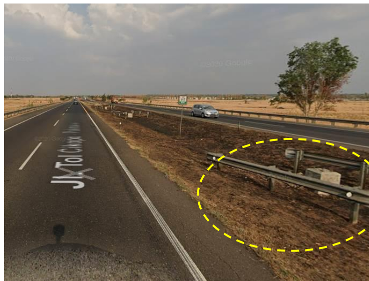
Gambar 9. Guardrail pada median jalan yang tertabrak mobil bus SJ sebelum terjadinya kecelakaan.
