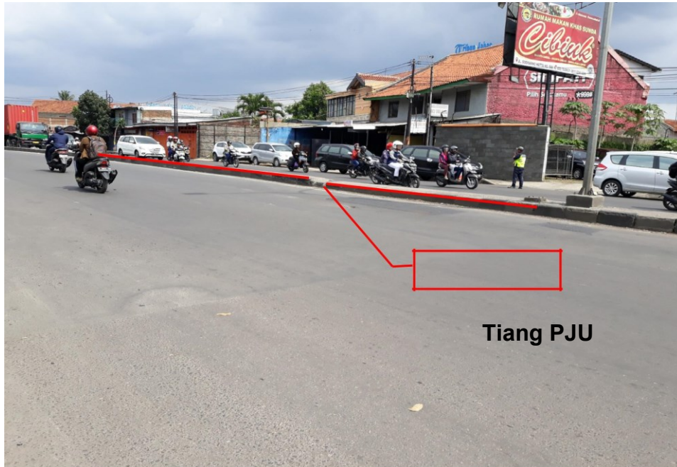
Gambar 7. Tiang PJU yang rusak
